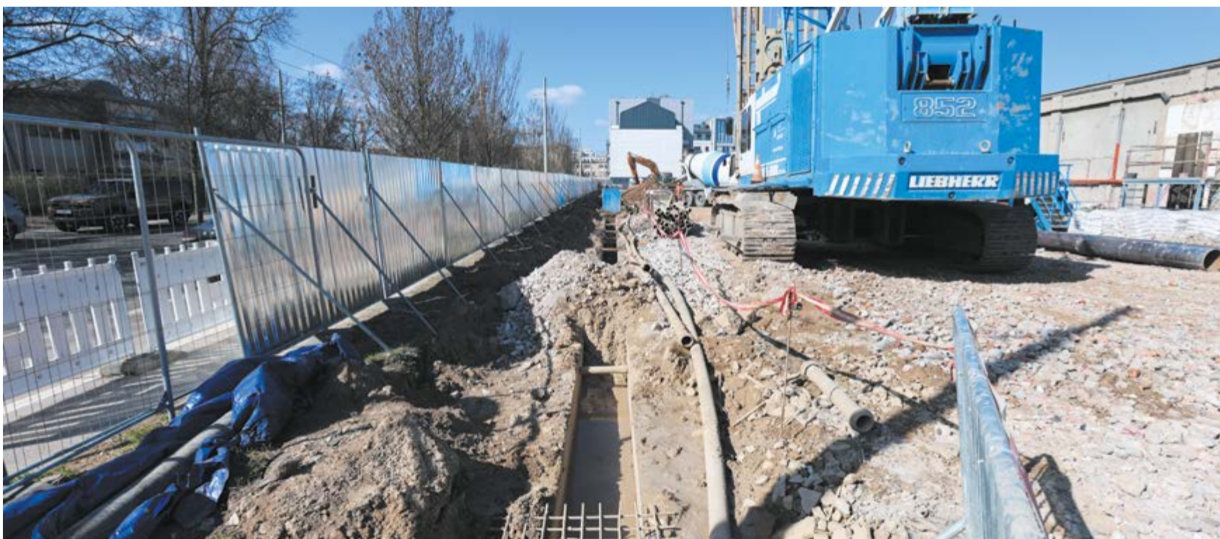
Na terenie zajezdni przy ul. Gajowej budowląnczy kończą betonowanie ścian szczelinowych pod budowę apartamentowców
